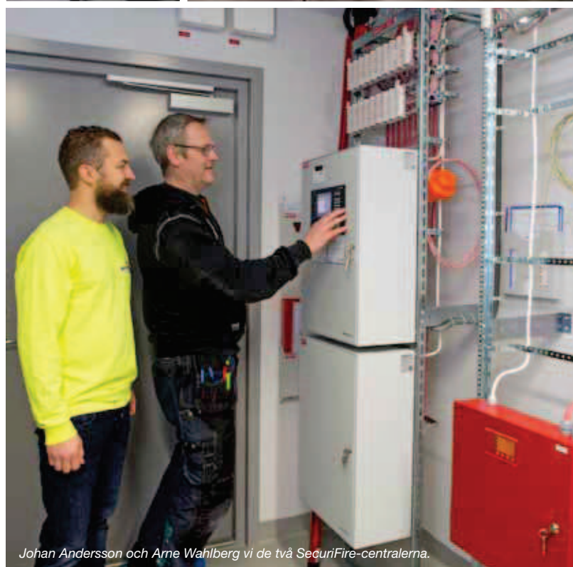
I tvätthallen har man aspirerande detektorer. Via samplingsrör monterade i taket övervakas luftflödet kontinuerligt. Högkänsliga röksensorer utvärderar luften.
