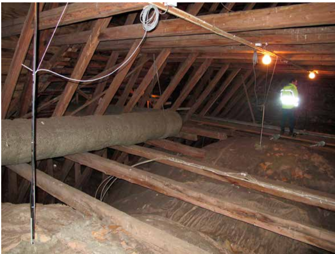
Fig.10. Bild till vänster. Ljuskronornas upphängning på vinden. Befintliga hål genom takvalven har utnyttjats för montering av detektorer i långhuset. Fotot är taget före åtgärderna genomfördes. LP_2015_00016, foto: K. Myhrberg.
