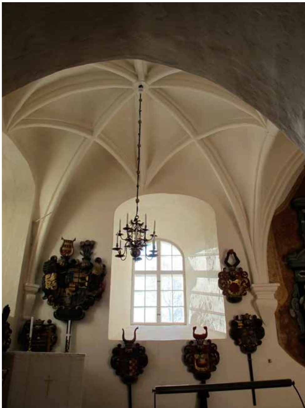
Fig.4. På bilden syns en ny, dock nästan osynlig detektor i ett valv mot söder. Fotot är taget efter den genomförda åtgärden. LP_2015_00011 foto: H. Bellberg.
