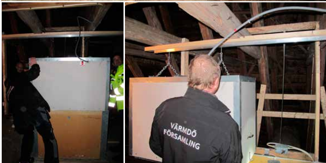
Fig.11. Efter installationerna hänger visserligen en del nya sladdhärvor över valvkapporna på vinden, men dragningarna har gjorts i befintliga hål genom valven. Se exempelvis t.v. i bild. LP_2015_00017, foto: H. Bellberg.
