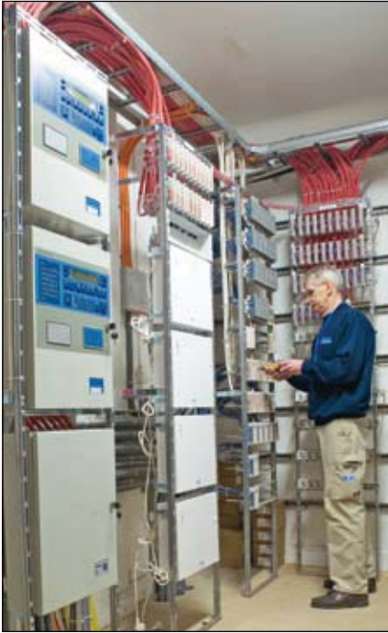
5 st centralapparater i ett nätverk.
