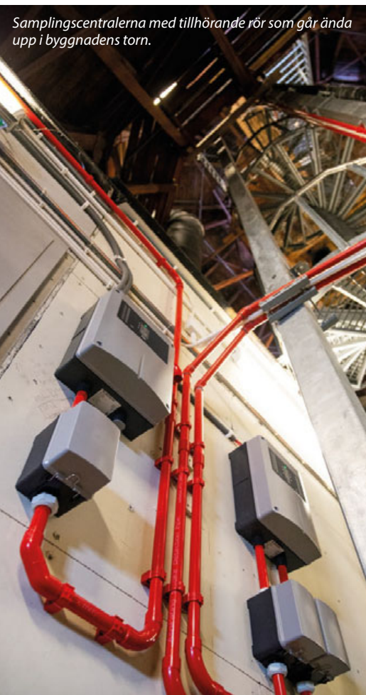
Det nya brandlarmsystemet består av 5 st SecuriFire centralapparater i nätverk.
